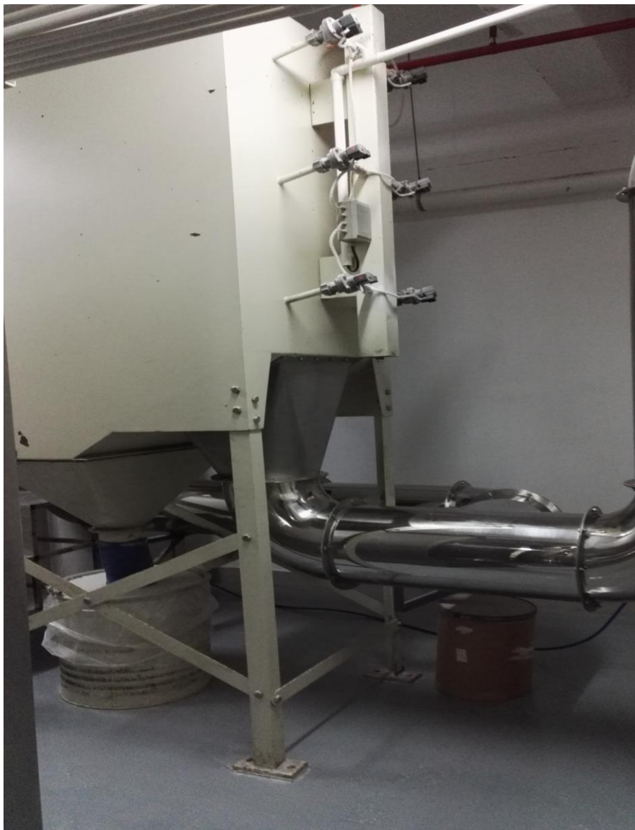
附件 5：废气处理工艺设施
